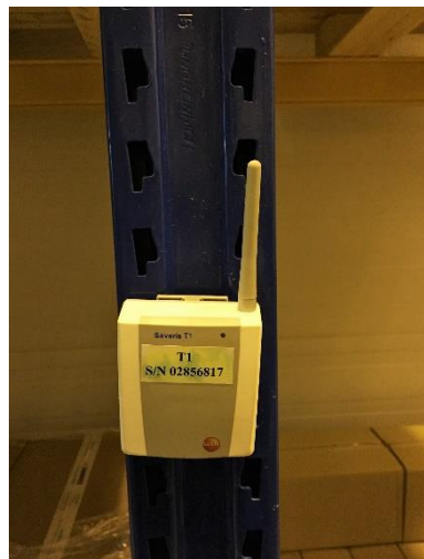
Терморегистратор холодильной камеры
